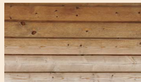
Väggen på en trädgårdsstuga som impregnerats brun och som har stått utomhus i fyra år utan ytterligare efterbehandling. Den del som utsatts för solen är kraftigt blekt.
